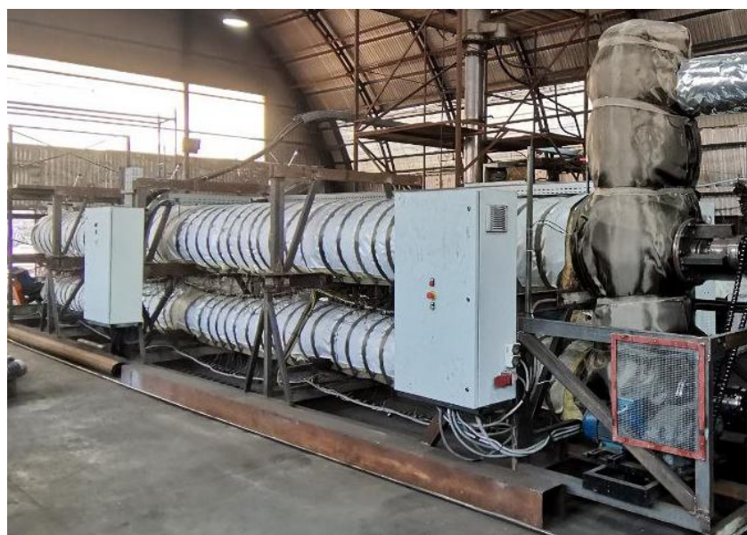
Рисунок 5.6. Общий вид реактора установки низкотемпературного термолиза Q=500 кг/ч
